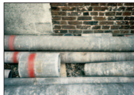
© INRS Canalisation en amiante ciment
