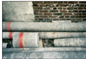
© INRS Canalisation en amiante
