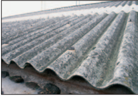
Crédits : INRS Toiture en amiante ciment
