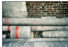
© INRS Canalisation en amiante ciment
